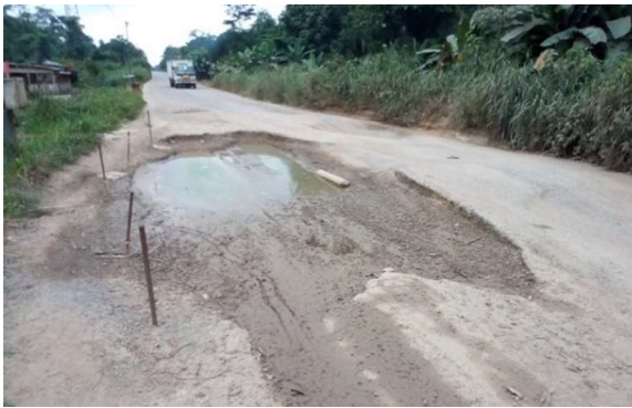
Figure 154 : Portion de route endommagée à Ebel Akok
