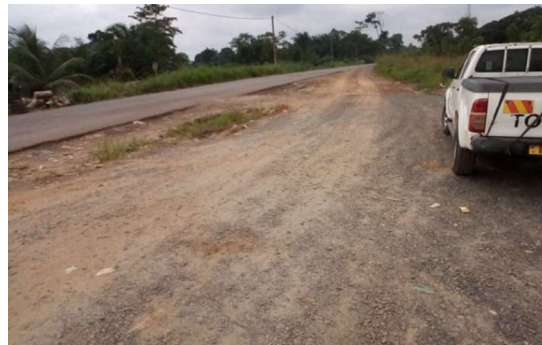
Figure 155 : Route endommagée à Okolassi
