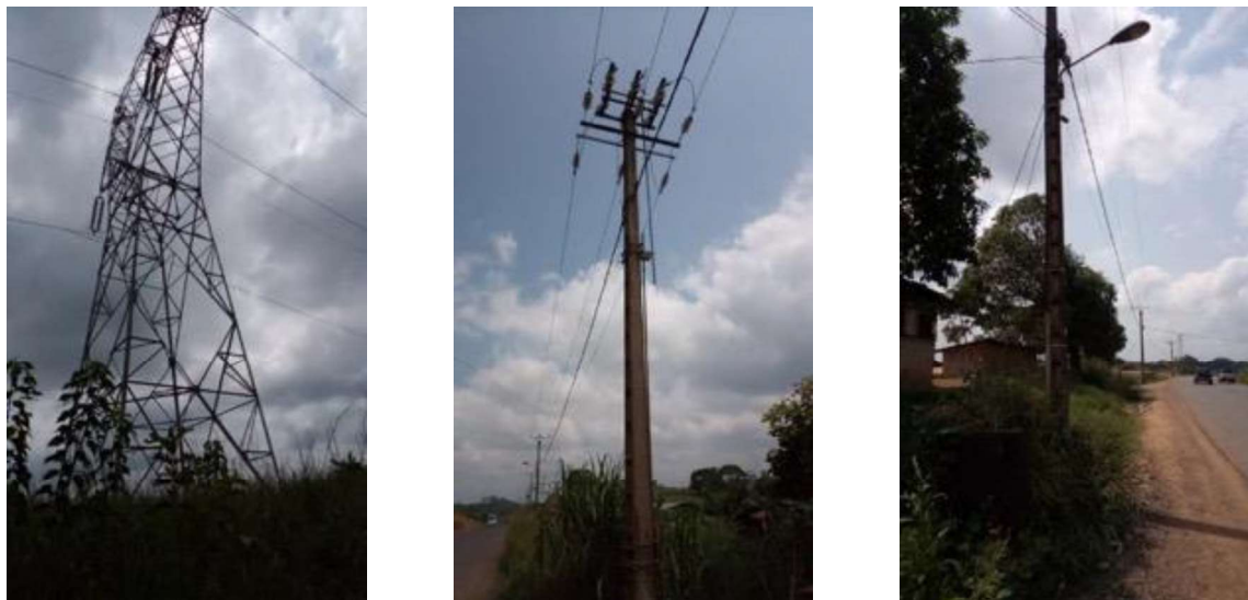
Figure 145 : De gauche à droite : lignes de haute, moyenne et basse tension
