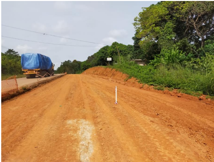
Figure 12 : Débordement des travaux au-delà de l'emprise au PK 51
